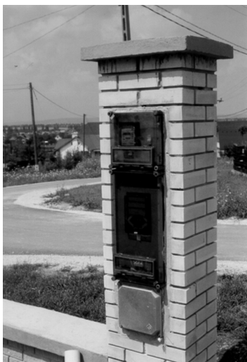
3.3.6. ábra. Kerítéspillérbe telepített fogyasztásmérő-hely (árnyékolás nélkül, szerelés alatt)
