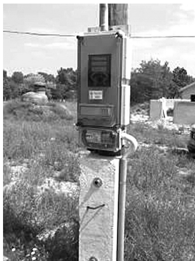
3.3.10. ábra. Építkezési ideiglenes fogyasztásmérő-hely oszlopon
